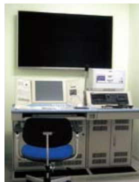
防災行政無線操作卓
