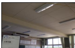
校舎教室照明(改修後)
