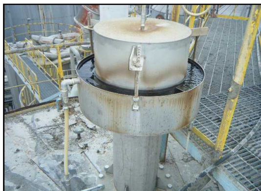
タンク排気口の水封設備
