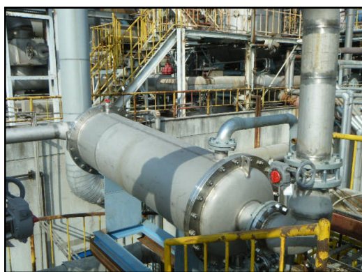
臭気ガスの熱交換器
