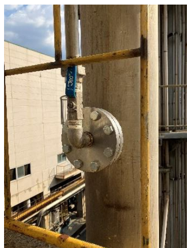
【増強した冷却水噴霧装置】
