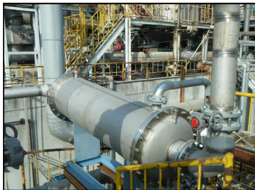
臭気ガスの熱交換器
