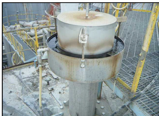
タンク排気口の水封設備
