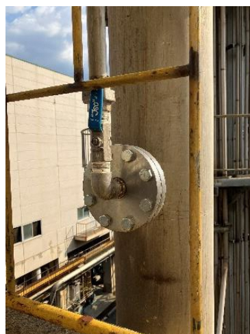
【増強した冷却水噴霧装置】
