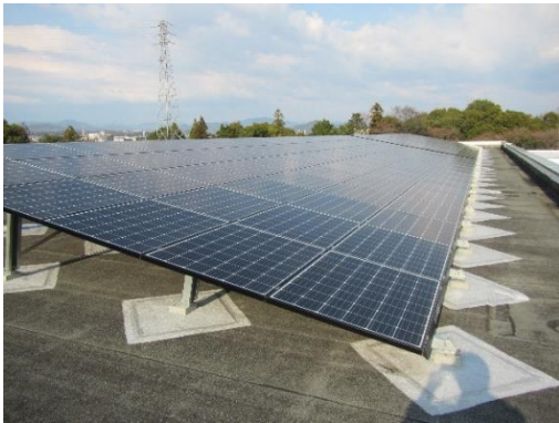
太陽光発電（土田小学校（屋根貸し））
