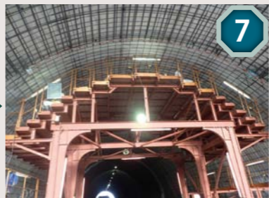
7 シート台車を使って、トンネル内全面を防水シートで覆い、補強用の鉄筋アーチを組み立てます。
