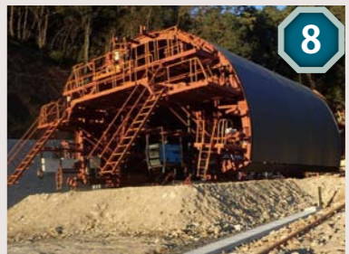
8 このトンネル専用のサイズで組み立てられたセトルで、コンクリートの壁を仕上げて完成です。
