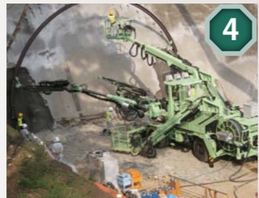
4 岩盤崩落の防止にドリルジャンボで鋼製アーチを建て込みます。
