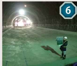
6 底部をコンクリート加工(インパート工)し、トンネル全体をより強固にします。
