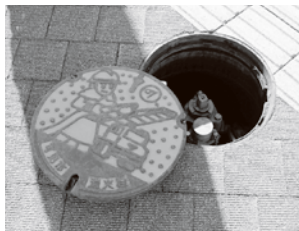
地下式消火栓
