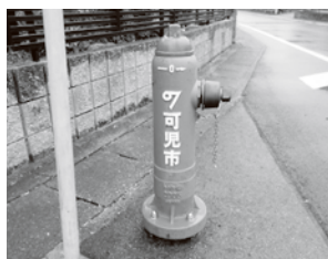
地上式消火栓
