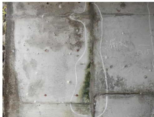
クラック確認（橋台部）
