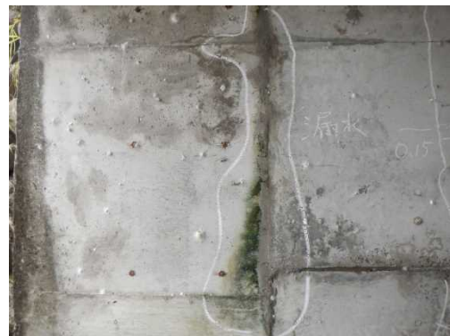
クラック確認（橋台部）
