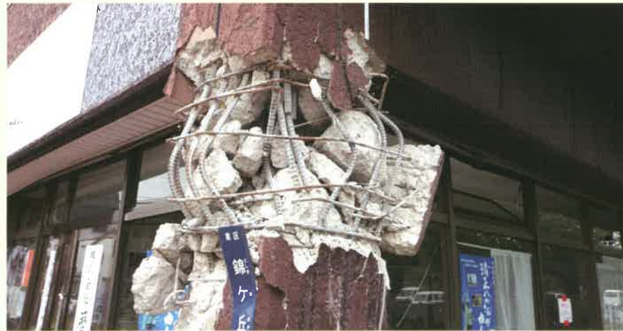
事務所ビル(鉄筋コンクリート造)の1階柱の局部座屈による破損
