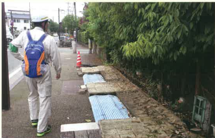
ブロック塀が歩道に倒れて道を塞いでいる
