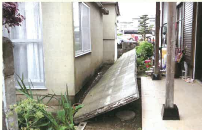
ブロック塀が隣地へ倒壊している
