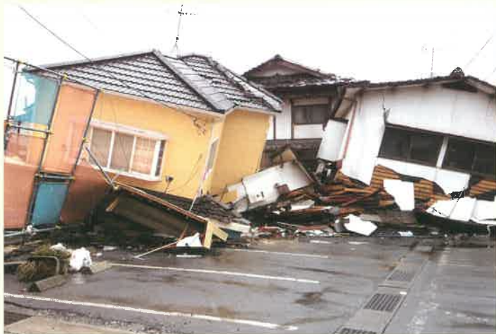
住宅(木造)の1階壁量不足により倒壊
