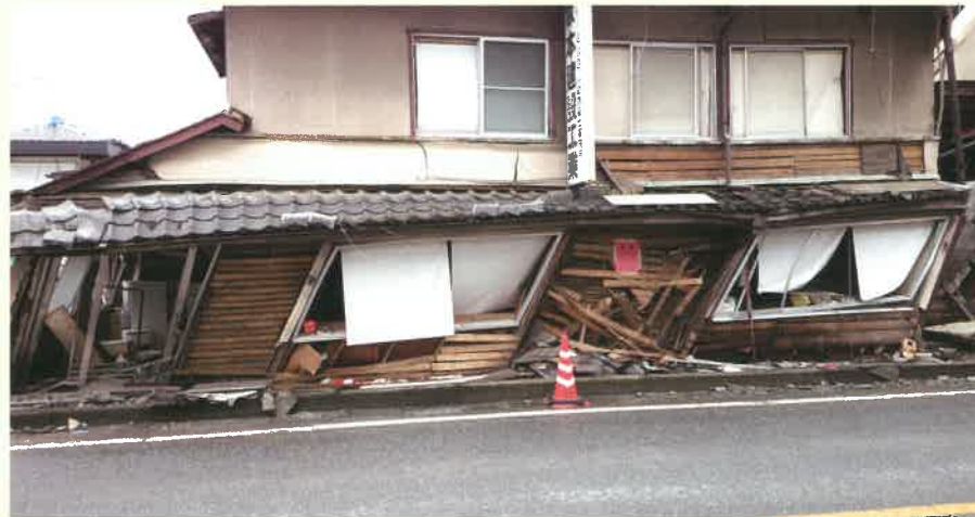
事務所併用住宅(木造)の1階壁量不足により1階が傾斜
