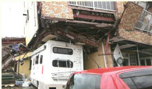
3階建住宅(鉄骨造)の2階が潰れ倒壊
