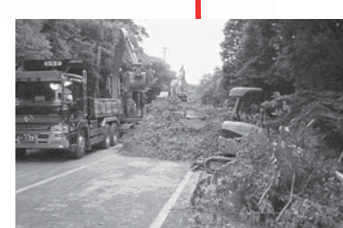
久々利地区の土砂崩れ現場。道路のアスファルトもはがす勢いであった。
