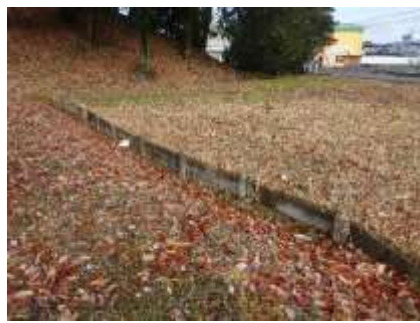
写真 20 コンクリート塀
