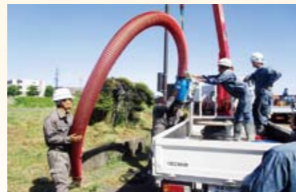
雨水などを排水するためのポンプの動作確認
