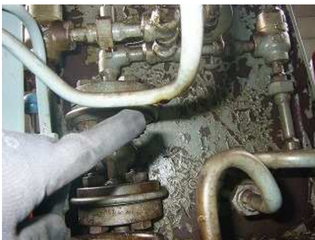
油圧ユニット漏油
