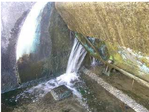
扉体の側面の止水機能低下による漏水
