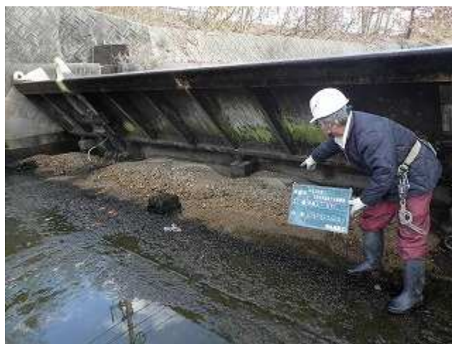
扉体下の堆積土砂
