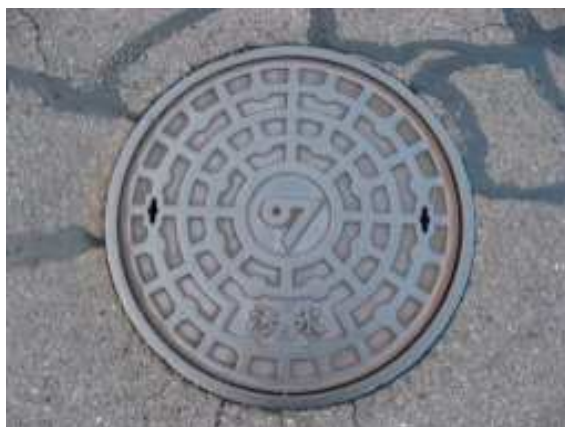
大型団地内マンホール蓋
