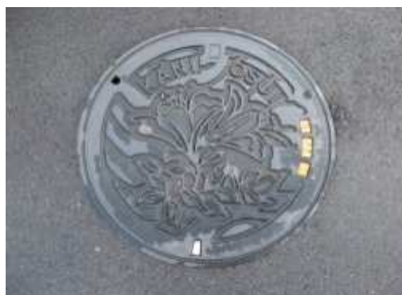
現在の仕様のマンホール蓋
