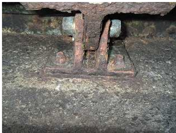
扉体ヒンジ部の発錆
